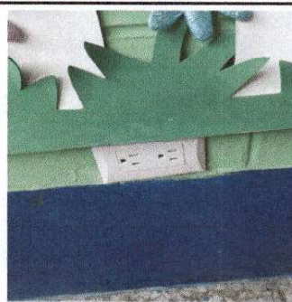
Foto 6: Sustrucción interruptores dobles
